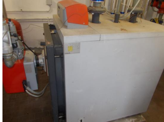
Figura 8.5 – Particolare della caldaia
