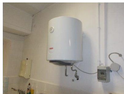
Figura 4.10 - Particolare di un boiler elettrico per la produzione di acqua calda sanitaria
